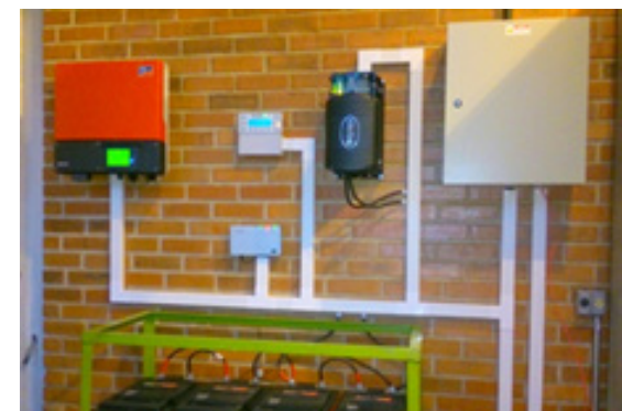
Sistema de acumulação em baterias para painéis solares.
